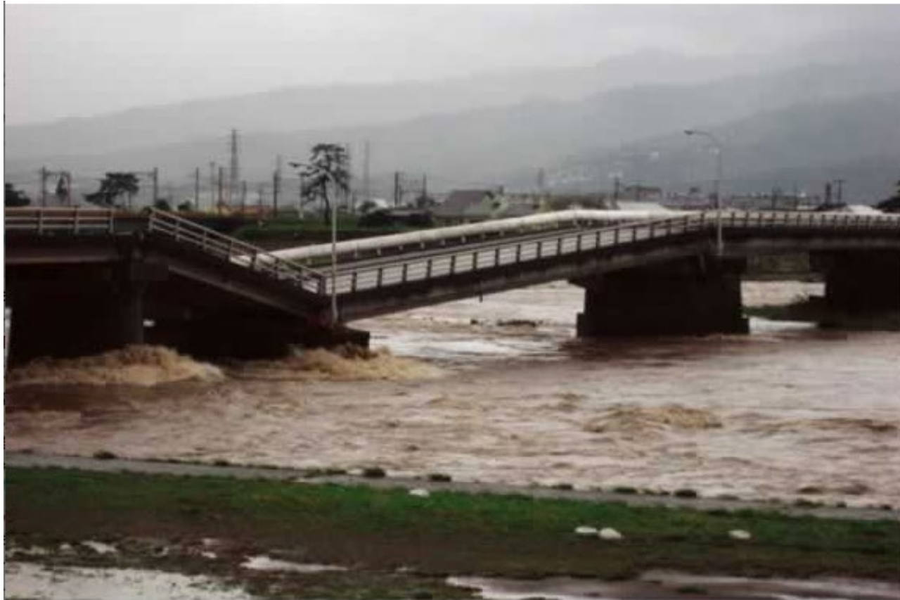
▲ 酒匂川の落橋被災状況（神奈川県松田市）
